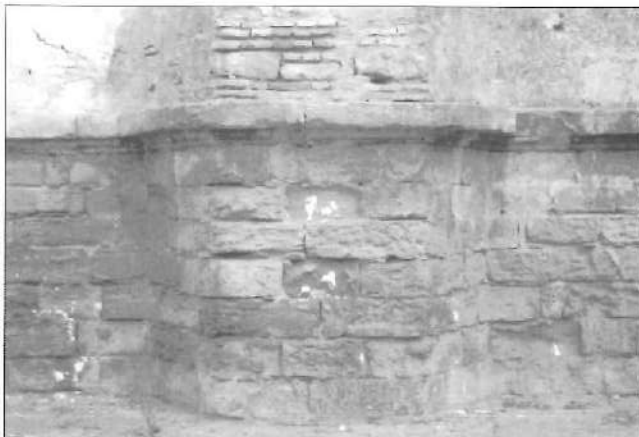
Fig. 5. Sillares a sustituir marcados con pintura blanca.
