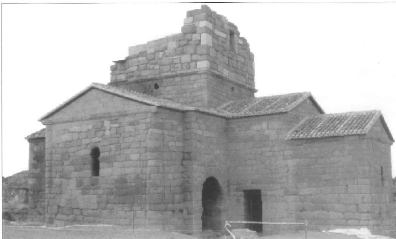
Fig.2. Estado de Santa María de Melque en el año 2000. Los trabajos están recuperando la volumetría primitiva del cimborrio.
